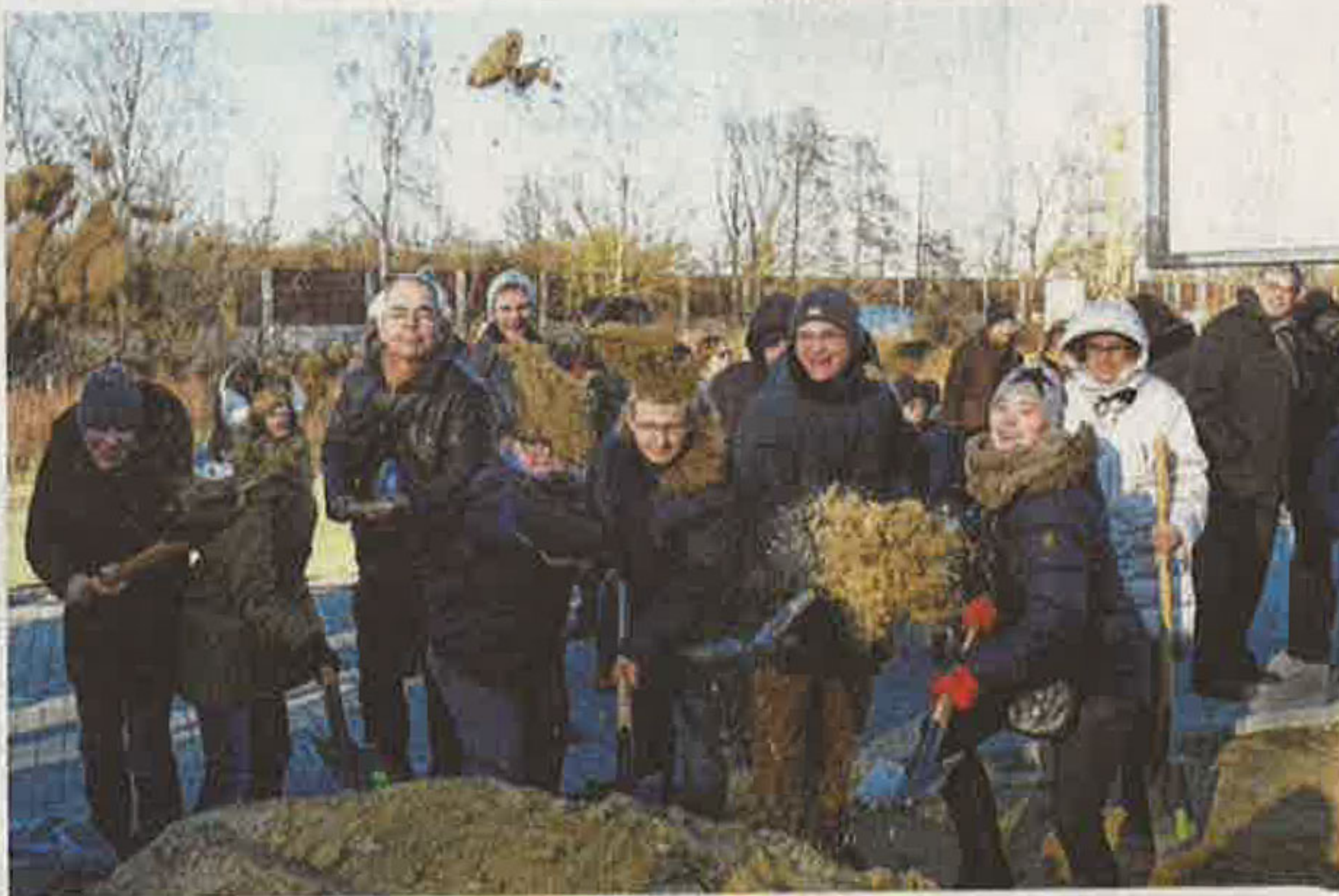
Gemeinsam angepackt: Architekt Josef Viethen (3.v.l.) und künftige Bewohner beim symbolischen ersten Spatenstich. Foto: Helmut Wichlatz
